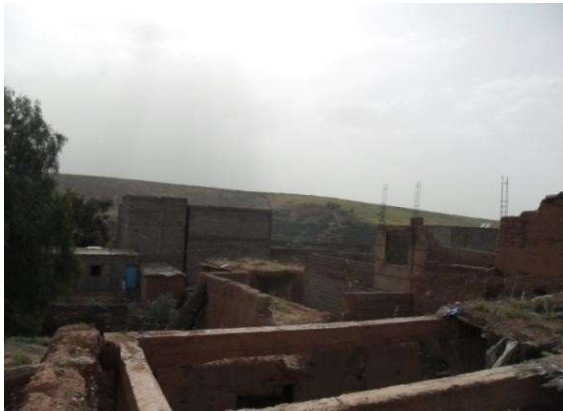
Dégradation du bâti traditionnel
